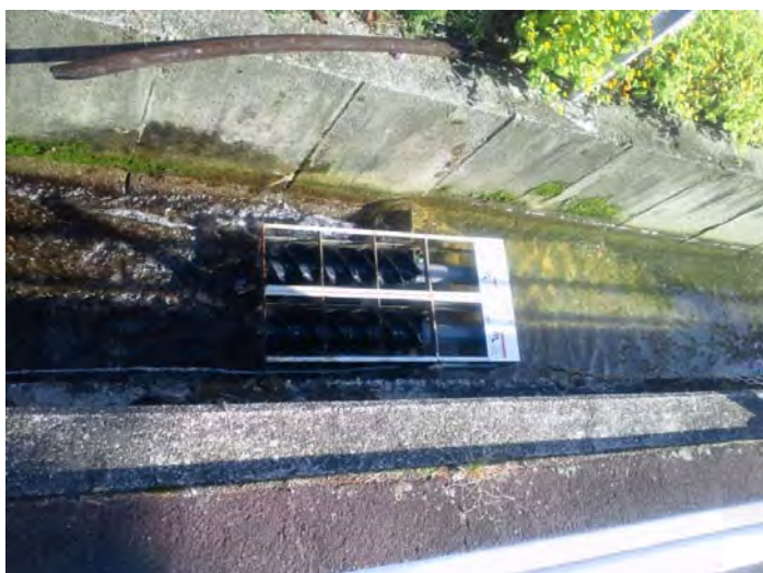
再生可能エネルギーの利活用 参考：小水力発電施設（岐阜県恵那市）
