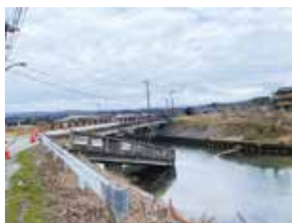
▲能登半島地震で崩れた橋
