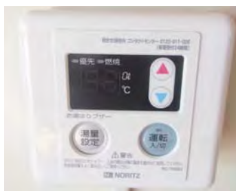
▲1台の給湯器で、浴室、 台所、洗面所の給湯が できます
