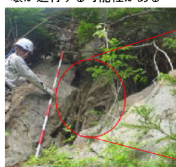
流れ盤の層理面亀裂発達
