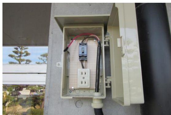
非常用コンセント
