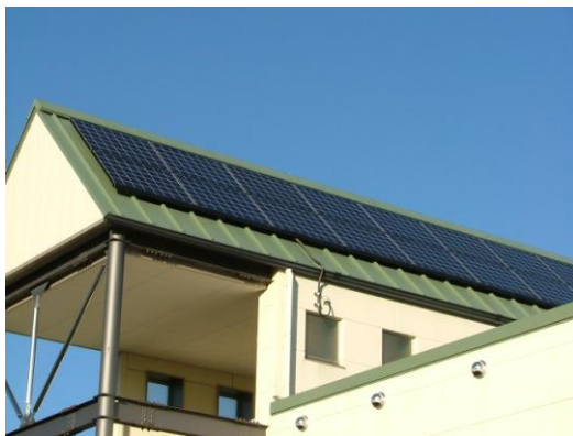
八名幼稚園の屋根に設置されている太陽光パネル
