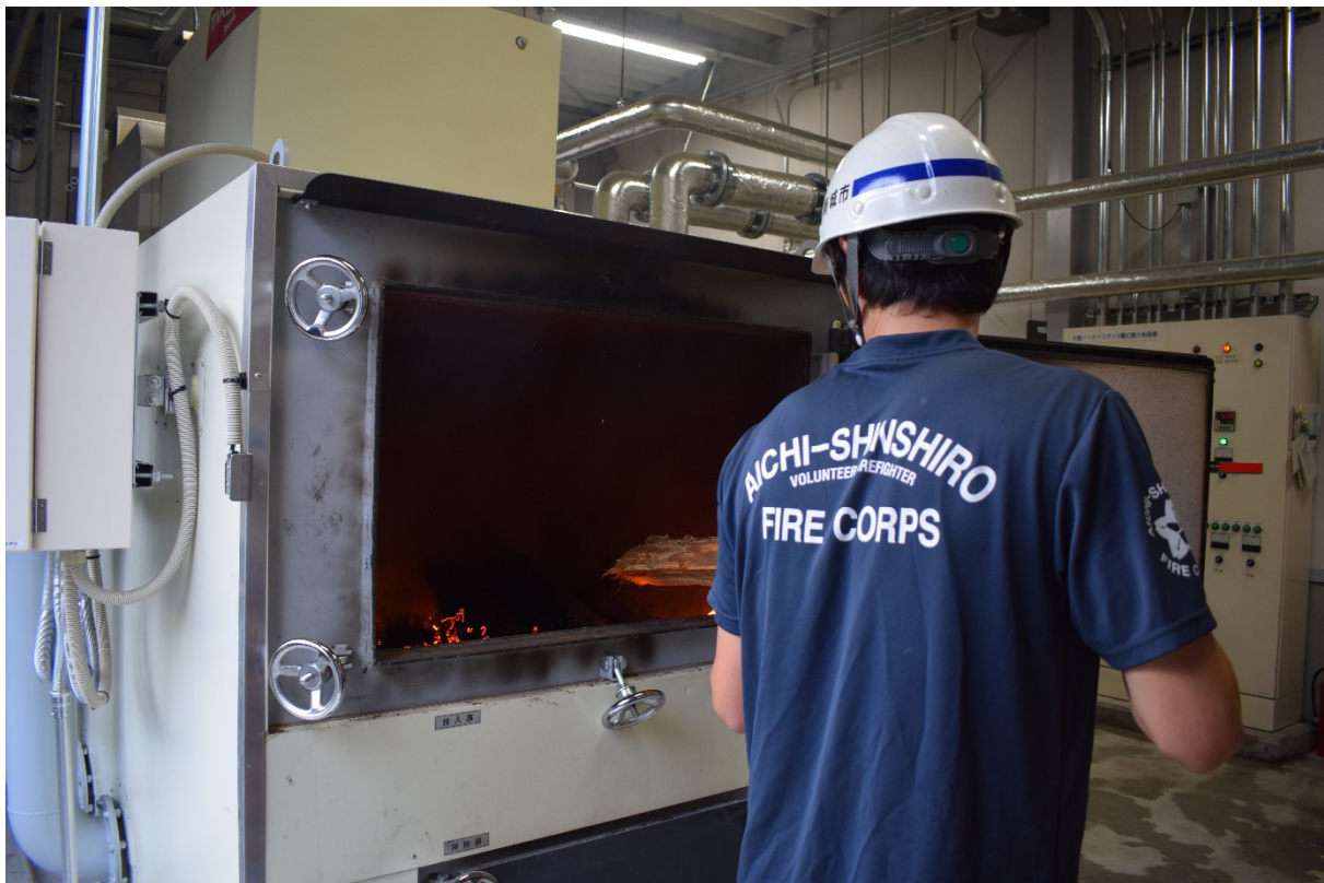
木質バイオマスボイラー -湯谷温泉-
