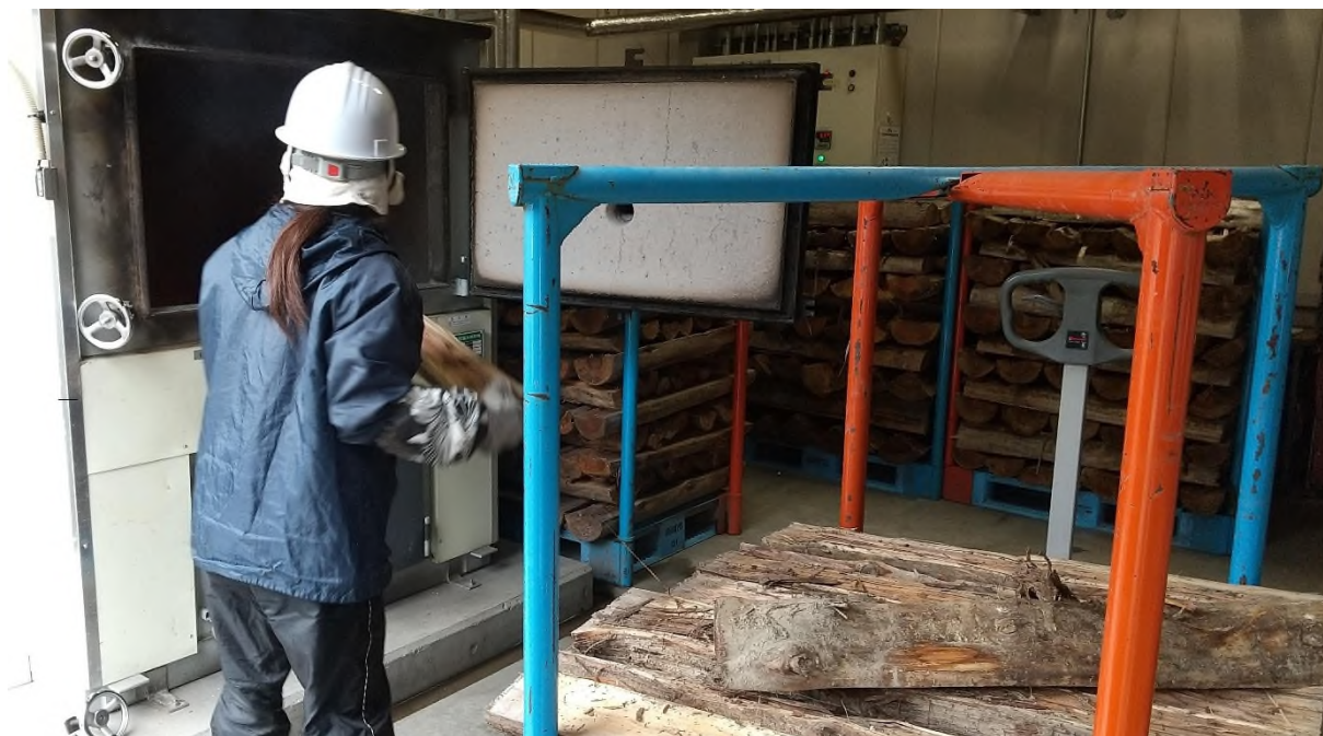
木質バイオマスボイラー -湯谷温泉-
