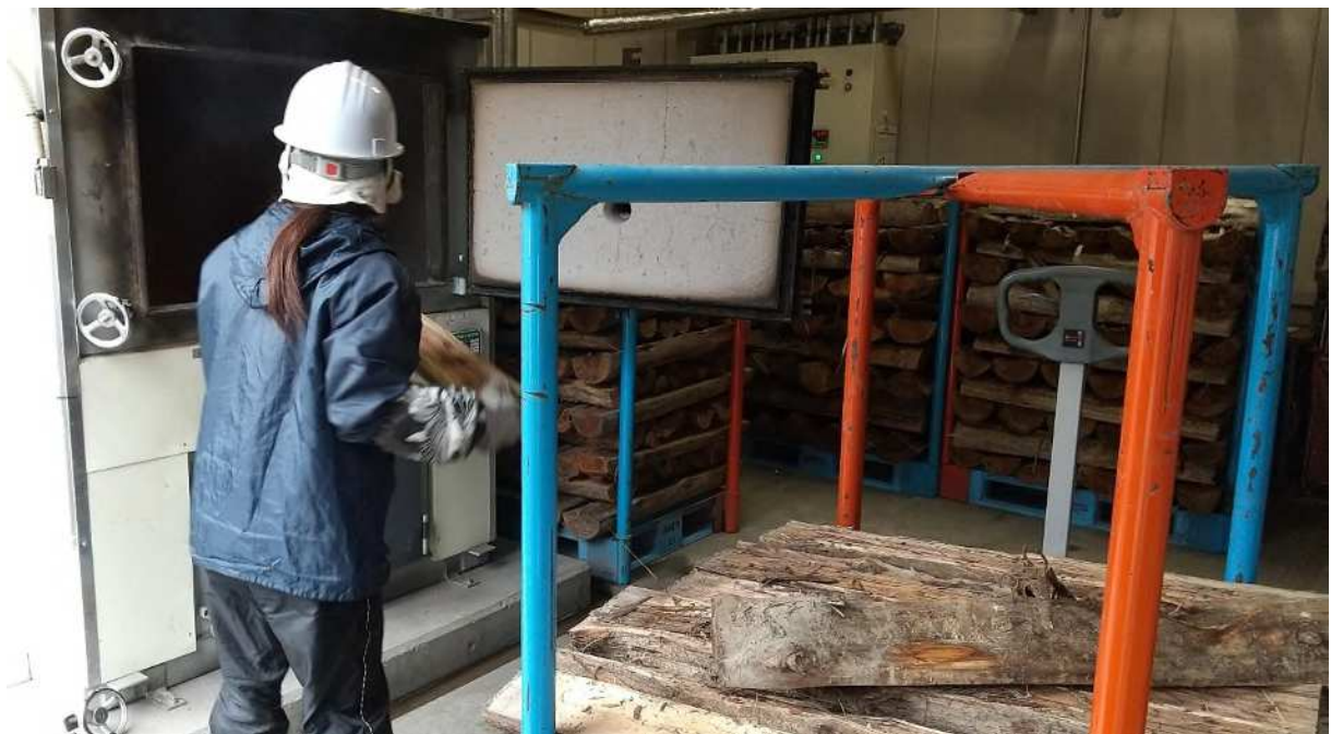
木質バイオマスボイラー -湯谷温泉-
