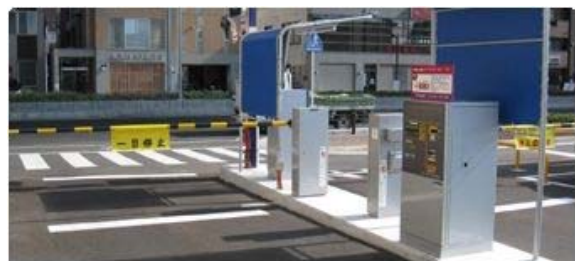
<駐車場を管理するゲート>
