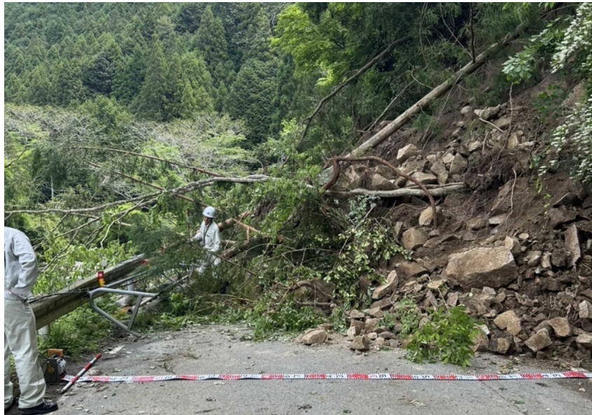
土砂崩れによる光ケーブルの断線現場（作手高松地区）
