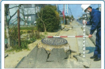
液状化によるマンホールの浮き上がり (平成23年、東北地方太平洋沖地震より)
