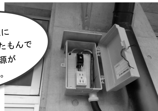
⑥非常用電源 最大出力1500W コンセント2カ所
