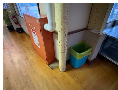
▲図3.3 危険部の様子
