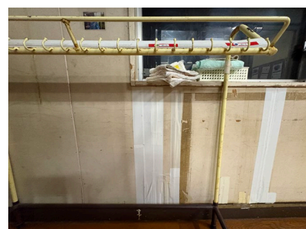
▲図 3.6 損傷部の様子
