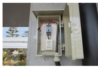
非常用コンセント
