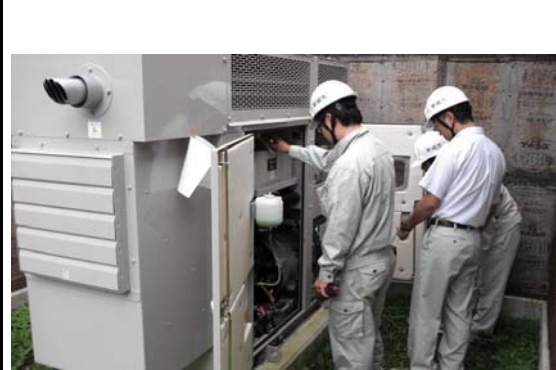
5 発電機確認状況
